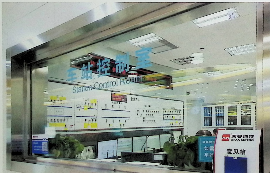
▲ 西安地铁 | 超大型甲级防火观察窗
